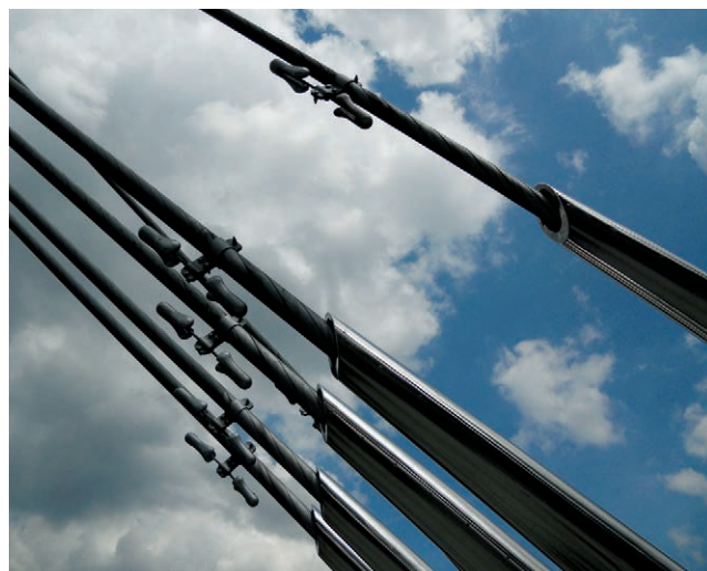
Detalj pozadinskih kabela
