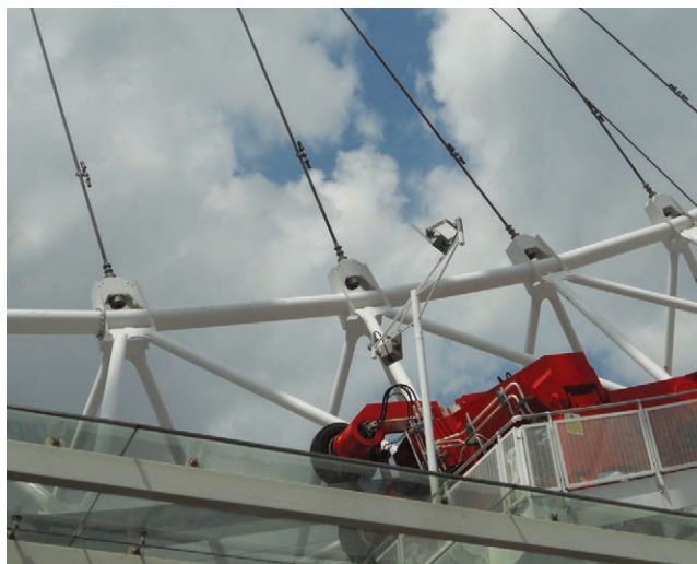
Na upetim je tornjevima glavni pogonski sustav koji upravlja kotačem
